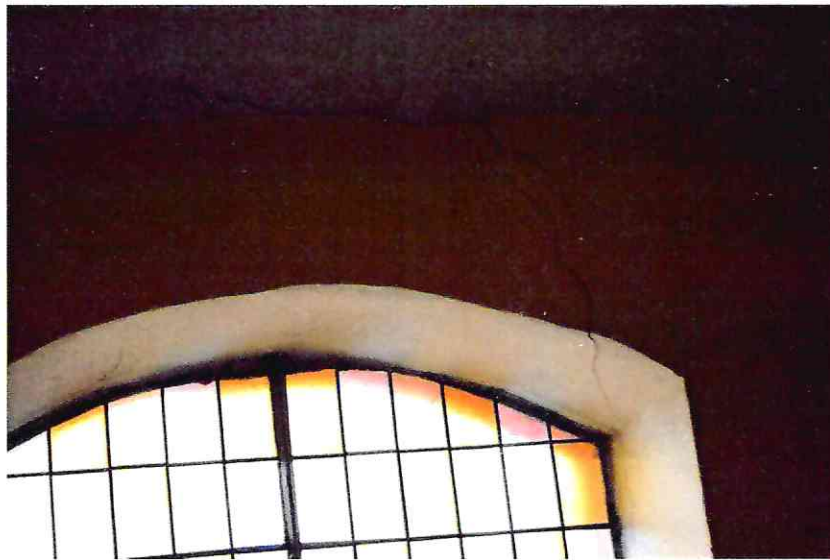
Fot. 32. Widok na rysę widoczną od wewnątrz kościoła w strefie łuku nadokiennego
