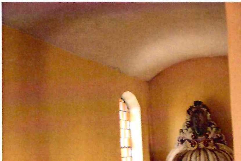
Fot. 34. Widok na rysę widoczną od wewnątrz kościoła w strefie łuku nadokiennego
