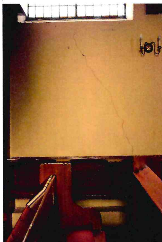
Fot. 28. Widok na rysę widoczną od wewnątrz kościoła w strefie podokiennej
