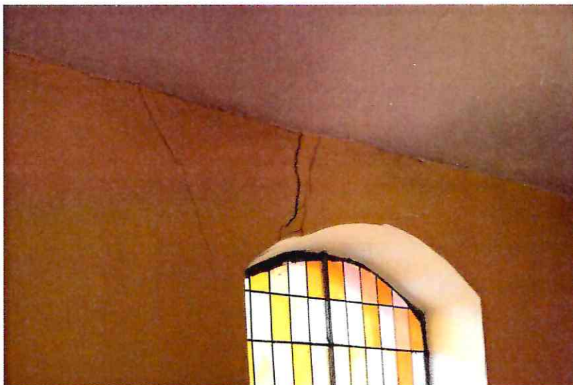
Fot. 33. Widok na rysę widoczną od wewnątrz kościoła w strefie łuku nadokiennego
