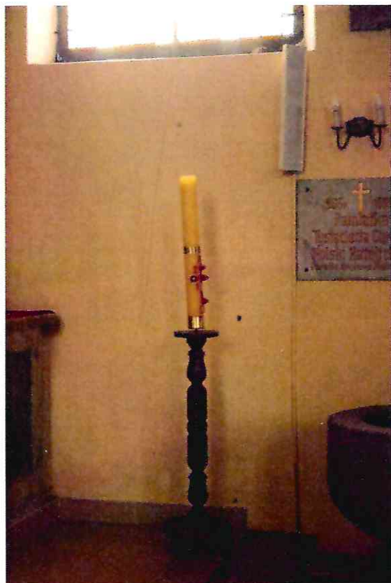
Fot. 26. Widok na rysę widoczną od wewnątrz kościoła w strefie podokiennej
